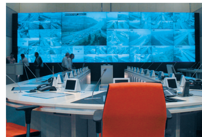
Центр управления чрезвычайными ситуациями (AKOM), г. Стамбул
